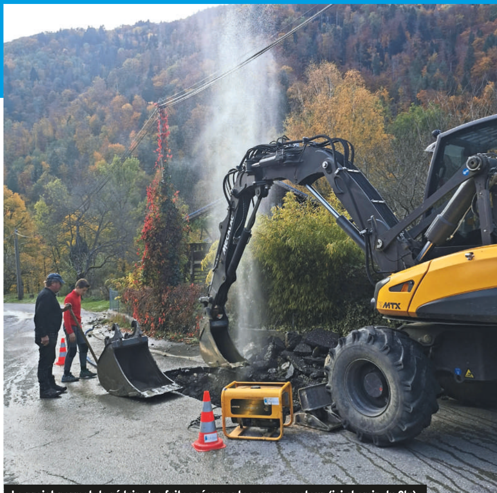
Le projet permet de réduire les fuites récurrentes sur ce secteur (ici chemin du Clu)
